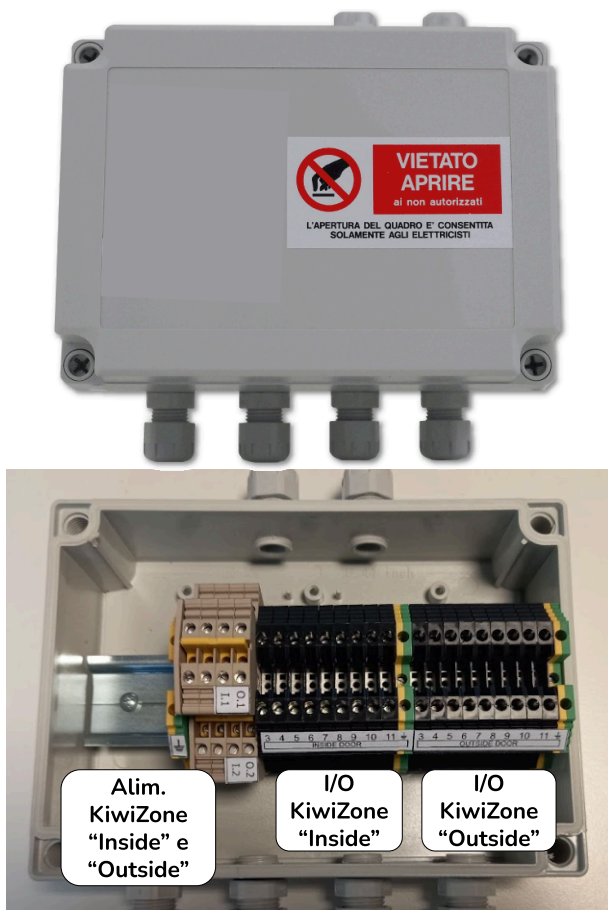
Fig.4 - Panoramica KiwiZone - Gate Quadro (M200500)
